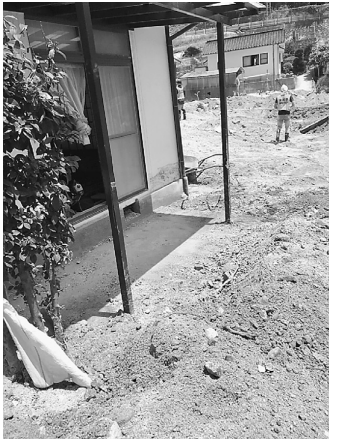
軒先の土砂をやっとかき出しました
